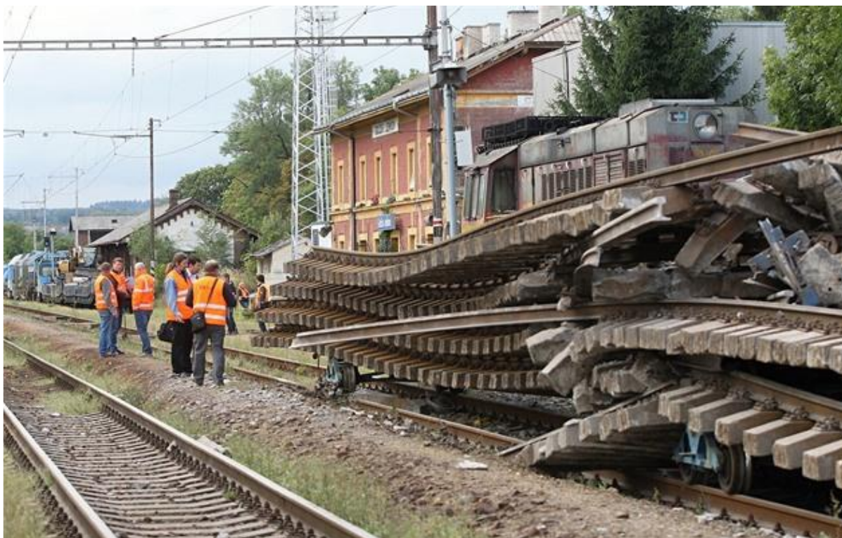
Slika 10.8: Po sprejetem investicijskem programu in po Zakonu o financiranju bo sedanja proga obratovala še vsaj deset let, drugi tir pa še 45 let. Progo je treba brezpogojno temeljito obnoviti kot to predvideva Resolucija v letih 2019 - 2022. Nedopustno je, da Ministrstvo za infrastrukturo pristaja na odložitev obnove na dokončanje drugega tira – brez strokovne analize nevarnosti, ki jo s tem povzroča.
